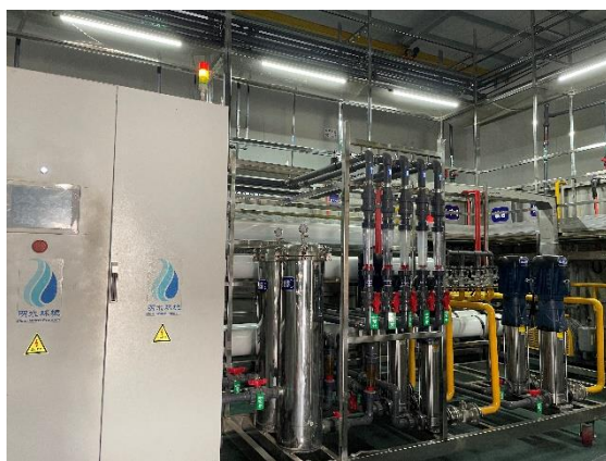
项目废水处理设施
