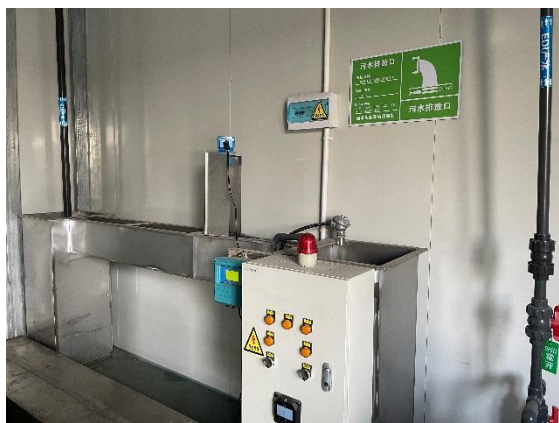
项目工业废水排放口
