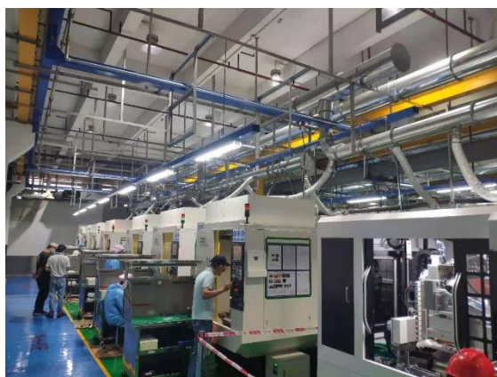
车间集气罩及收集管道
