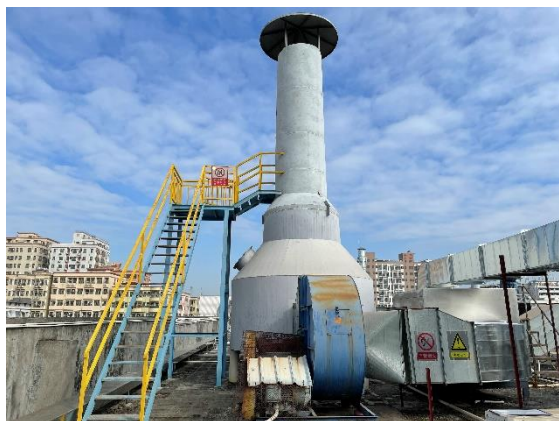
项目“二级活性炭吸附”装置及排放口
